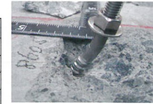
せん断試験破壊形態例 (斜め抜け)
